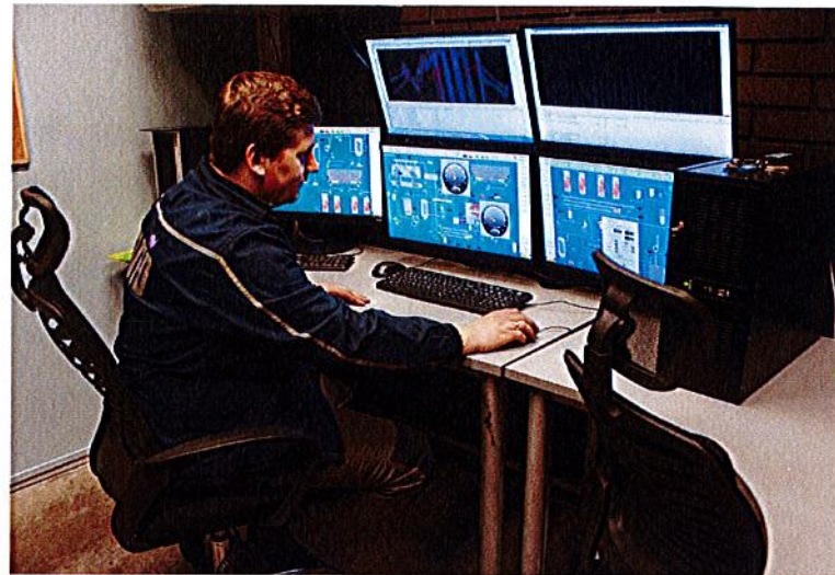
Stanowisko operatora linii technologicznej
