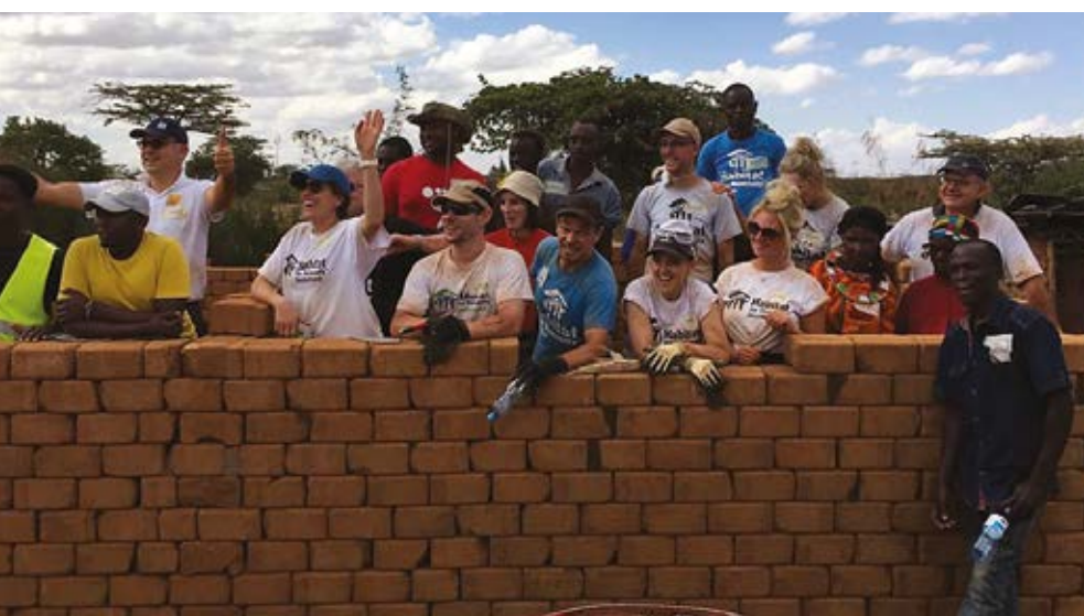
Pracownicy spółki GWI podczas budowy domu opieki dla niepełnosprawnych dzieci w Kenii. GWI employees during the construction of a nursing home for disabled children in Kenya.
