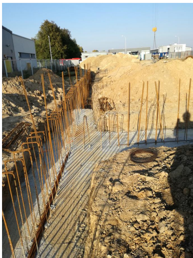
Roboty ziemne na budowie Zakładu Produkcyjnego oraz Centrum Badawczo-Rozwojowego na należącej do BioMaxima SA działce w Specjalnej Strefie Ekonomicznej w Lublinie.
