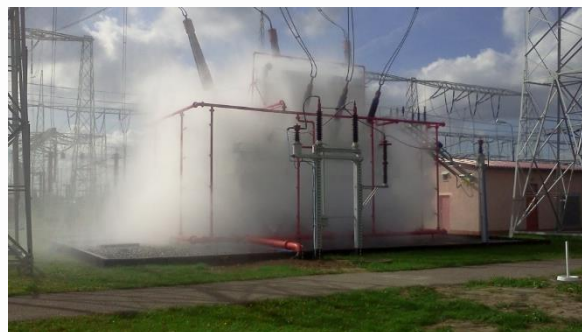
Gaszenie Stacji Transformatorowej
