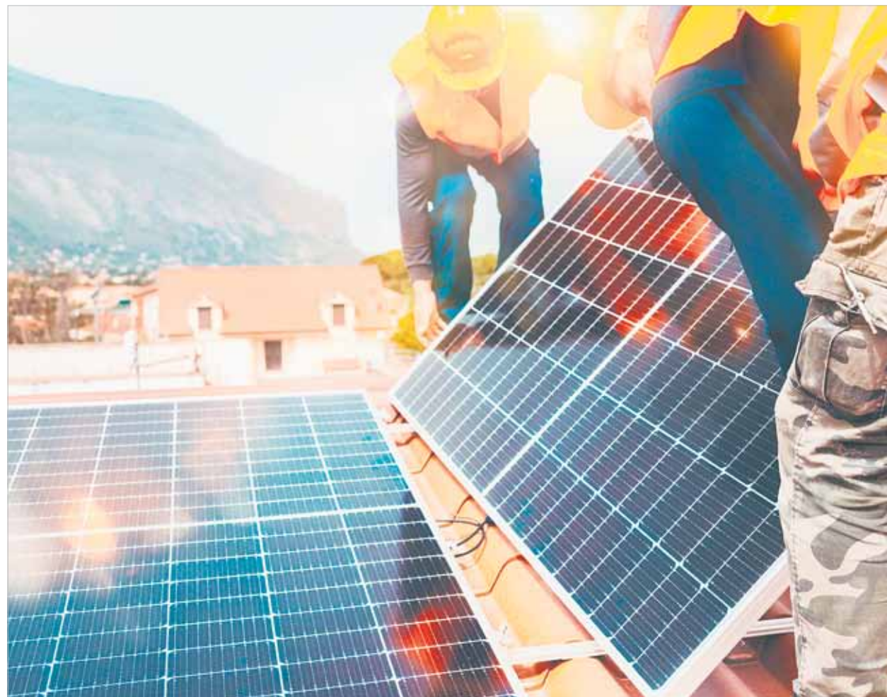
Moc źródeł fotowoltaicznych to ok. 15 GW (wrzesień 2023 r.). Rekord potencjału produkcji to ok. 62 proc. mocy zainstalowanej w tym źródle
