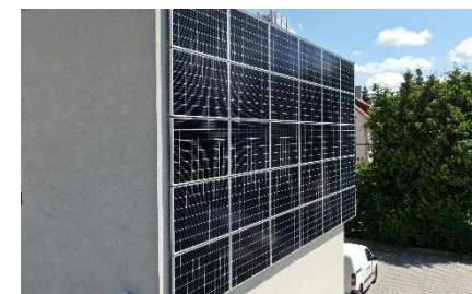
Fot. 18 Instalacja PV na fasadzie budynku
