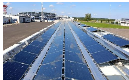
Fot. 17 Instalacja PV na dachu przedsiębiorstwa
