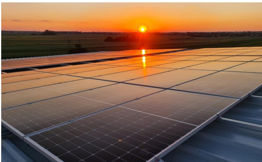
Fot. 13 Instalacja dachowa MŚP
