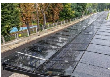
Dworzec Pszczyna – moduły NoFrost
