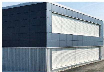
Inwestycja Somiral Energy Supplies SA – fotowoltaiczna fasada wentylowana
