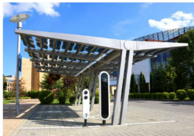
Carport ze stacją ładowania WSPiA Rzeszów
