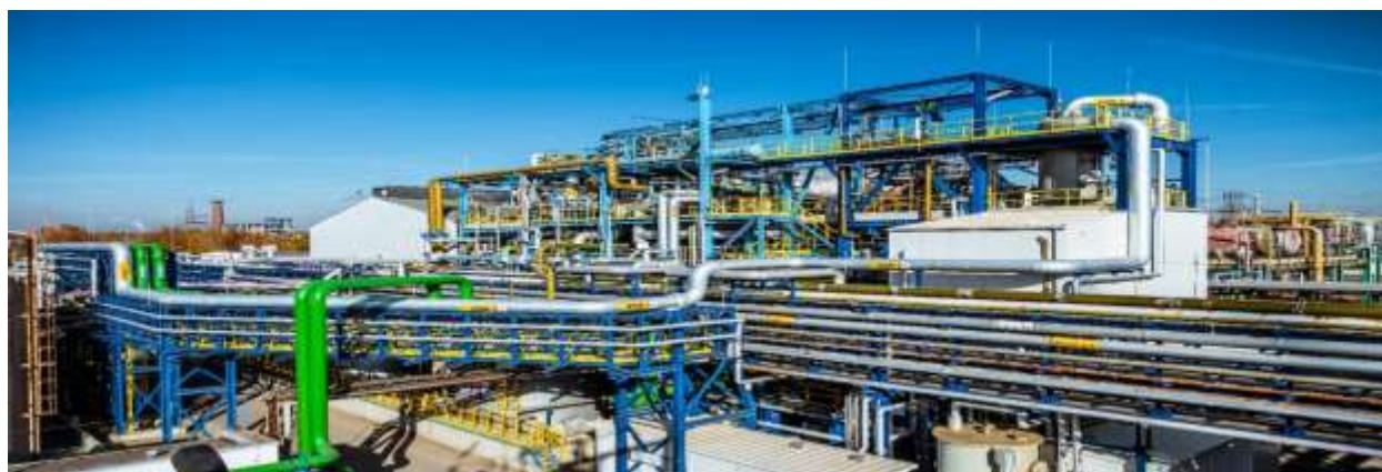
Instalacja elektrolizy membranowej, Segment Chloropochodne, Kompleks Chloru, fot. PCC Rokita
